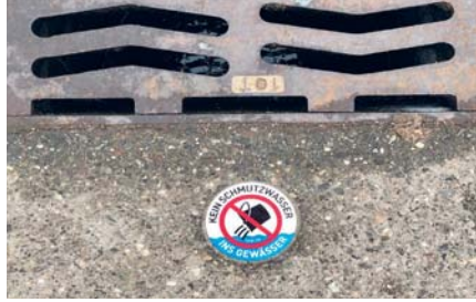
Strassenentwässerung mit Informationsplakette
