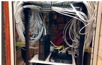
Hubschrank der Gemeinde-Informatikanlage
