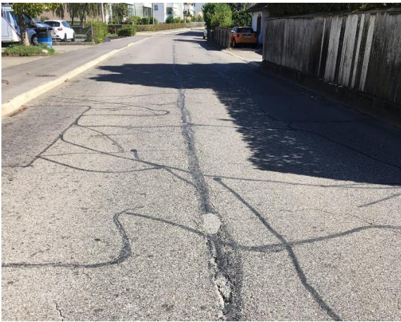
Abb. 1 Belagsschäden Landgarbenstrasse 30 Starke Rissbildung bei der Mittelfuge
