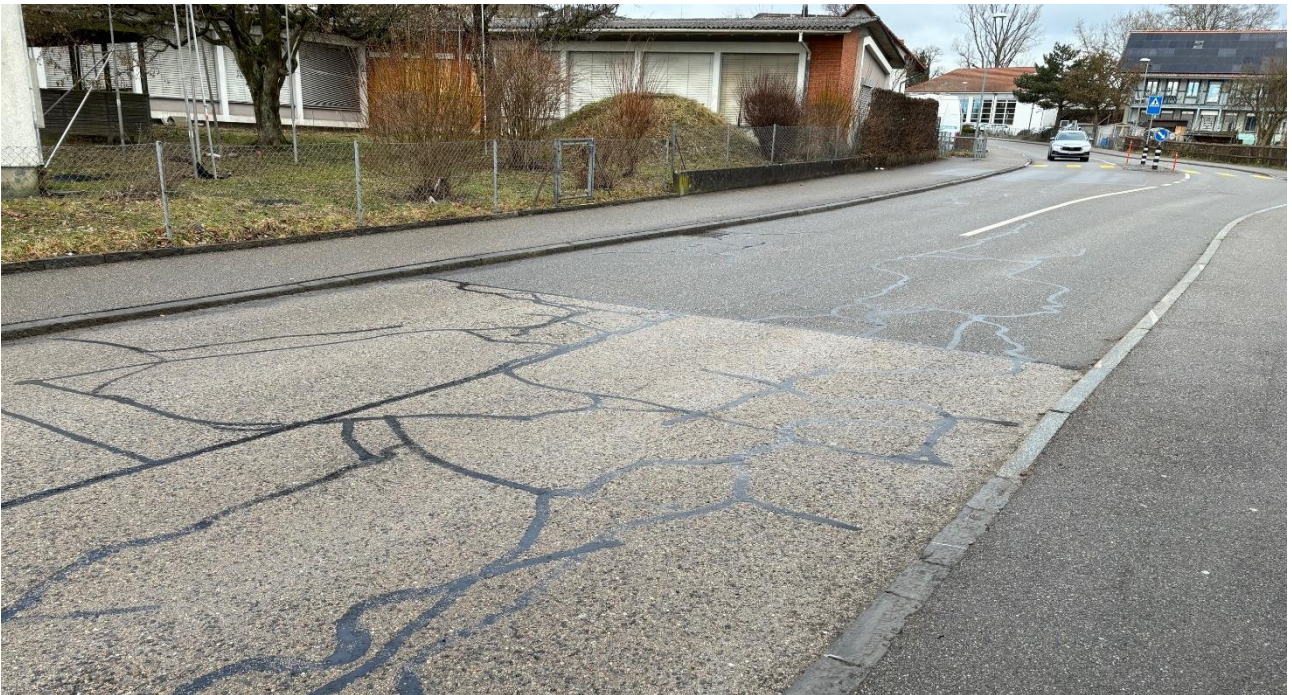
Abb. 1 Belagswechsel beim ehemaligen Kindergarten Lindenweg mit starker Rissbildung
