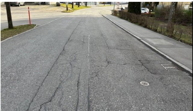
Abb. 1 Belagsschäden (Lätternweg 4) Links prov. Belag Fernwärme Mitte alter Deckbelag mit Rissen Rechts prov. Belag Wasserleitung
