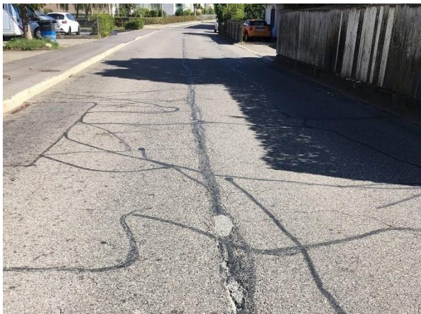
Abb. 1 Belagsschäden Landgarbenstrasse 30 Starke Rissbildung bei der Mittelfuge
