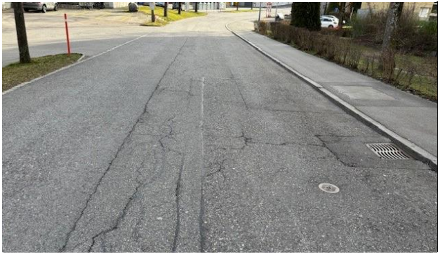
Abb. 1 Belagsschäden (Lätternweg 4) Links prov. Belag Fernwärme Mitte alter Deckbelag mit Rissen Rechts prov. Belag Wasserleitung
