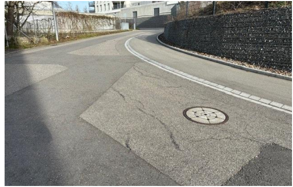
Abb. 2 Belagsschäden (Lätternweg 34) Dunkler Belag Fernwärme Heller Belag = alter Deckbelag mit Rissen Alte Schachtabdeckung Kanalisation
